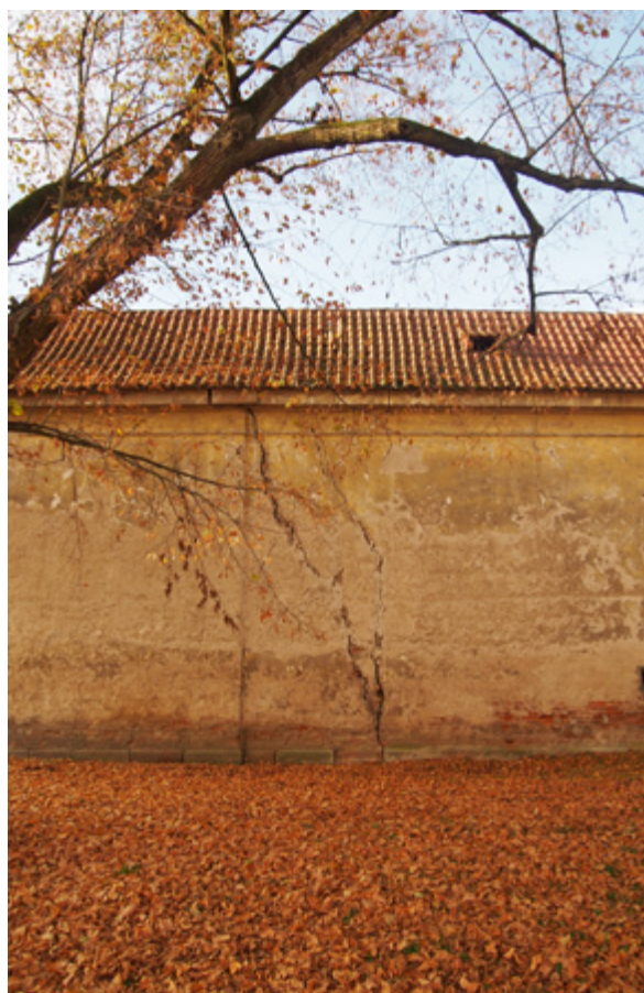
trhlina ve zdi - klášter Plasy
