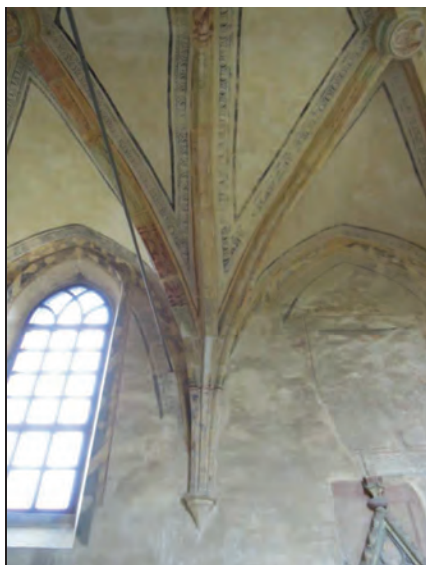
Severní strana presbytéria – nerovnosti v sesazení žebel
