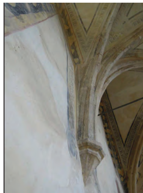
Jižní stěna presbytéria – nepřesné osazení výběhů žebor do líce stěny
