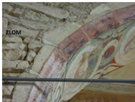
Jižní strana triumfálního oblouku, pohled z lodi – klínovité spáry v přezděné části oblouku
