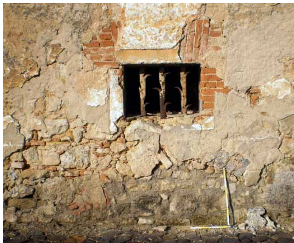
NÁLEZOVÁ SITUACE Č. JE - ZBYTKY VYNÁŠECÍCH ZÁKLENKŮ (MALÝ CIHELNÝ A VELKÝ KAMENNÝ), KTERÉ PŘEKRAČOVALY ROH STARŠÍHO SKLEPA, ZASAHOJÍCÍ MIMO PŮDORYS BAROKNÍ BUDOVY. PO DLOU- HODOBÉM ZATÉKÁNÍ SE ZDIVO V TOMTO MÍSTĚ VYVALILO A SITUACE TAK BYLA NEVRATNĚ POŠKOZENA. SOUČASNÝ STAV PO OPRAVĚ.
