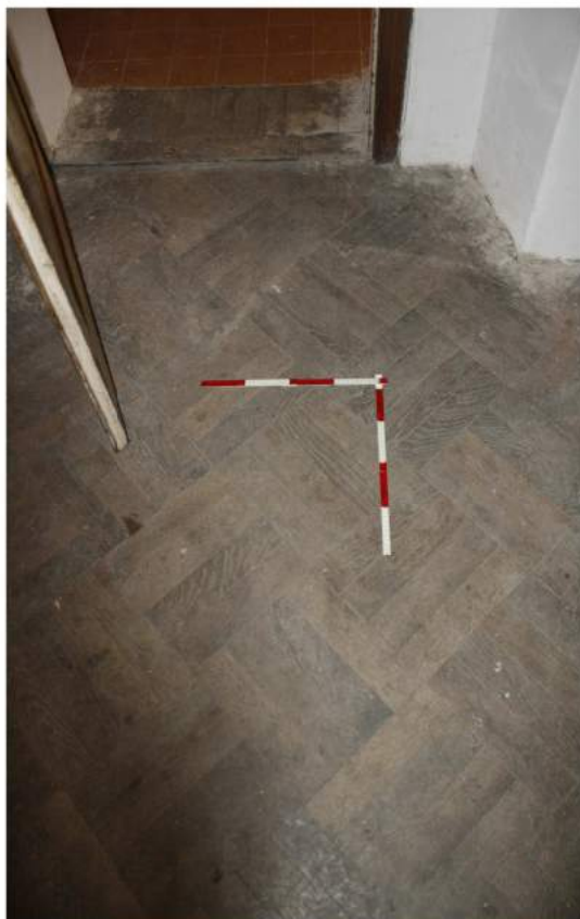
Pohled na podlahu u vstupních dveří do místnosti
