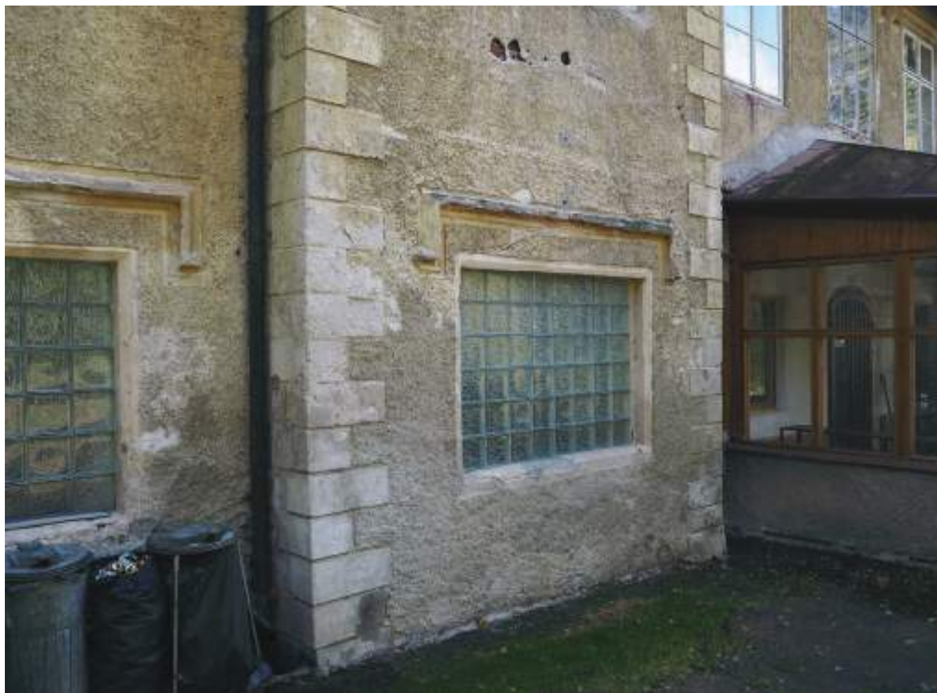
^ nevhodné výplně okenních otvorů v přízemí tzv. cottage a zasklení předjezdu před vchodem do zámecké budovy (2019) [foto autor]
