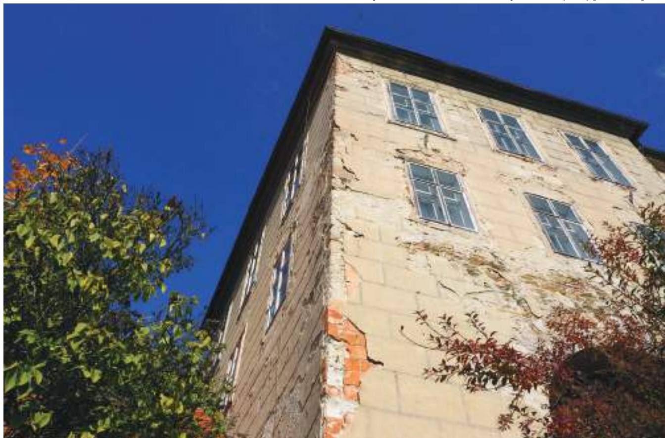
stav omítek na východní části zámecké budovy s bránou (2019) [foto autor] v
