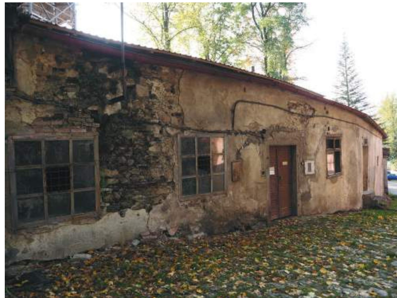
^ jižní křídlo hospodářského dvora, do kterého zatéká a trpí nadměrnou vlhkostí. (2019) [foto autor]
