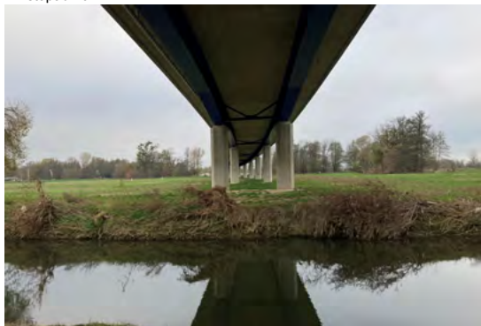
Dopravní most městského obchvatu - otevřená krajina pod mostem byla během povodní zatopena
