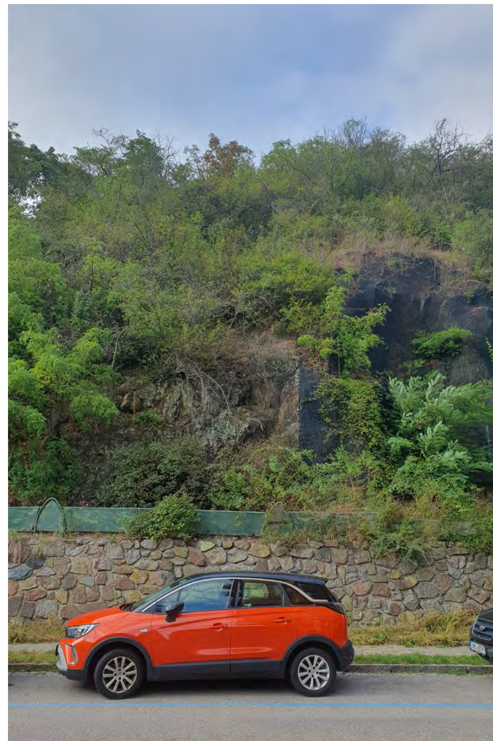
fotografie 98 — Odhalené svahy terénního zářezu z ulice Grohova, 2024
