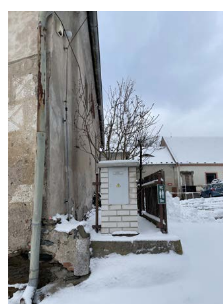
Detail provedení elektroinstalačního zařízení u V fasády předzámčí.
