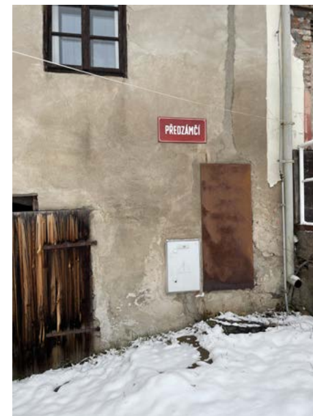
Detail elektroinstalace v J fasádě předzámčí.
