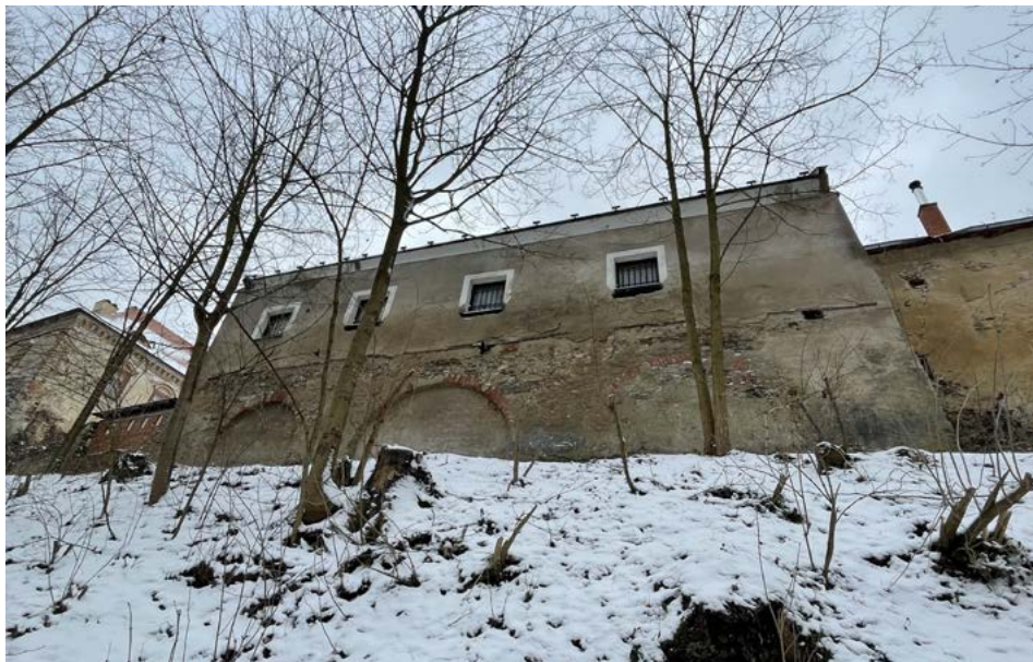
S strana stodoly předzámčí, ve fasádě je znatelné podsklepení objektu, dle dostupné dokumentace není sklepení využitelné.
