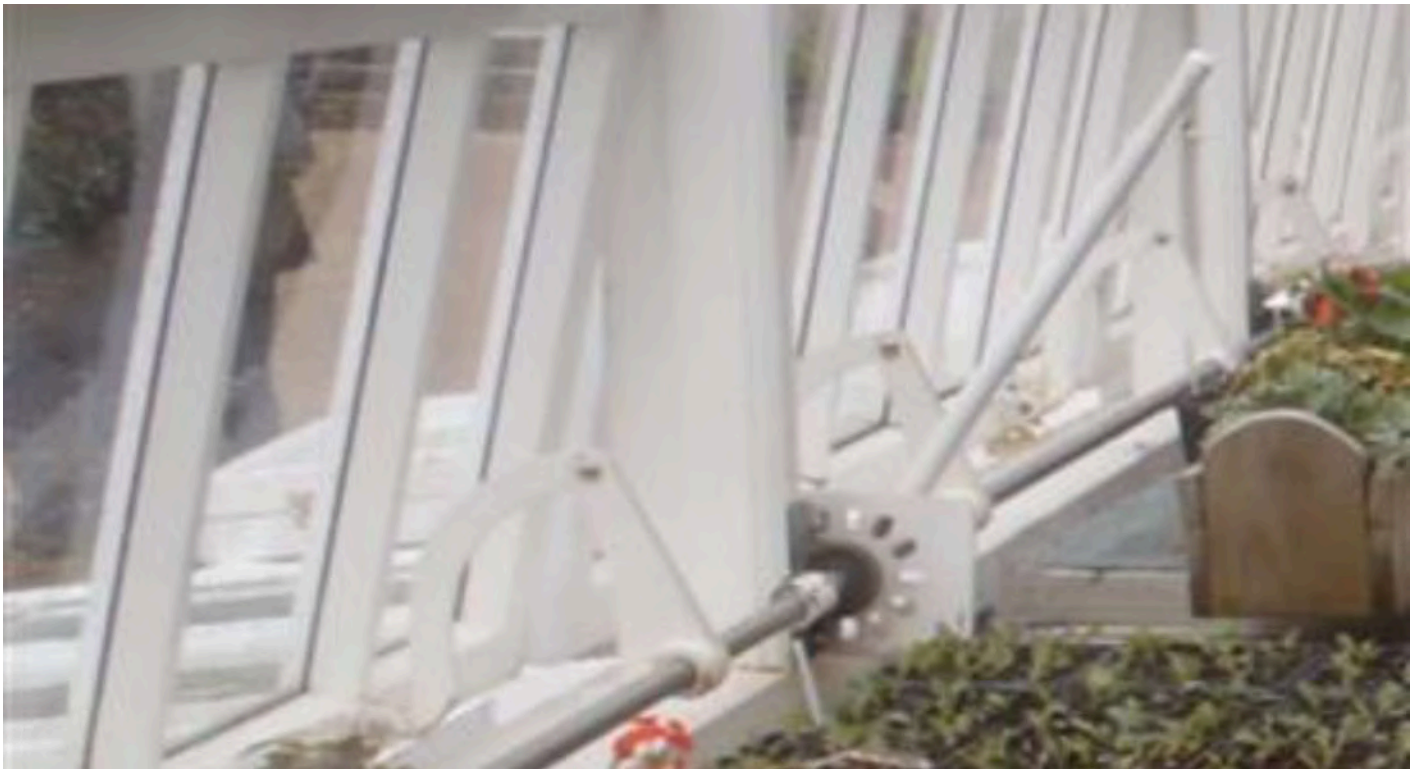
1- systém jendnotného otevírání oken 2 - vnitřní stínění a mechnizmus k spouštění, foto: anglie skleníky
