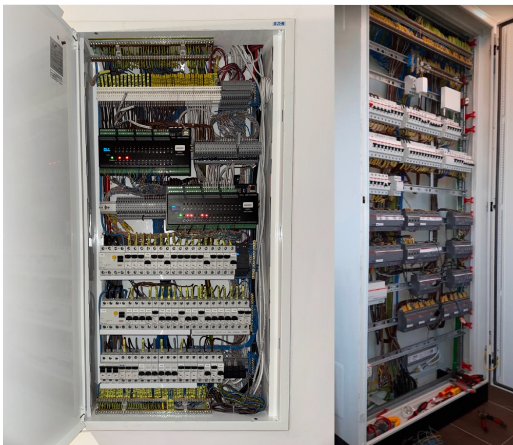
Obr. 20 Rozváděč chytrého domu, Kristýna Botnar, Obr. 21 Rozváděč chytrého domu, ABB
