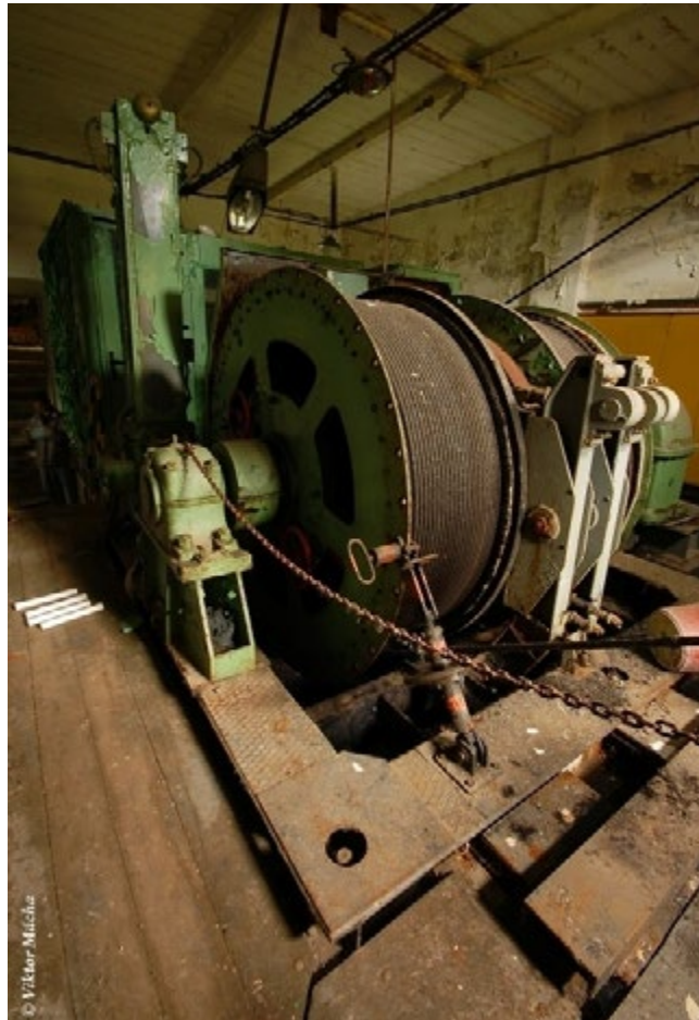
strojovna staré jámy - těžní stroj ČKD B 1606 (zdroj: rd-medenec-zavod-vaclava-rezace.webnode.cz)
