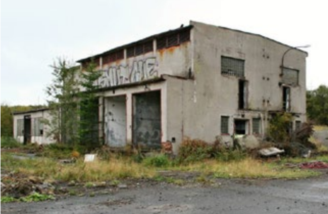
trafostanice s kompresovnou v pozadí, 2020 (zdroj: NPÚ ú.o.p. Ústí nad Labem, Páral Matěj)
