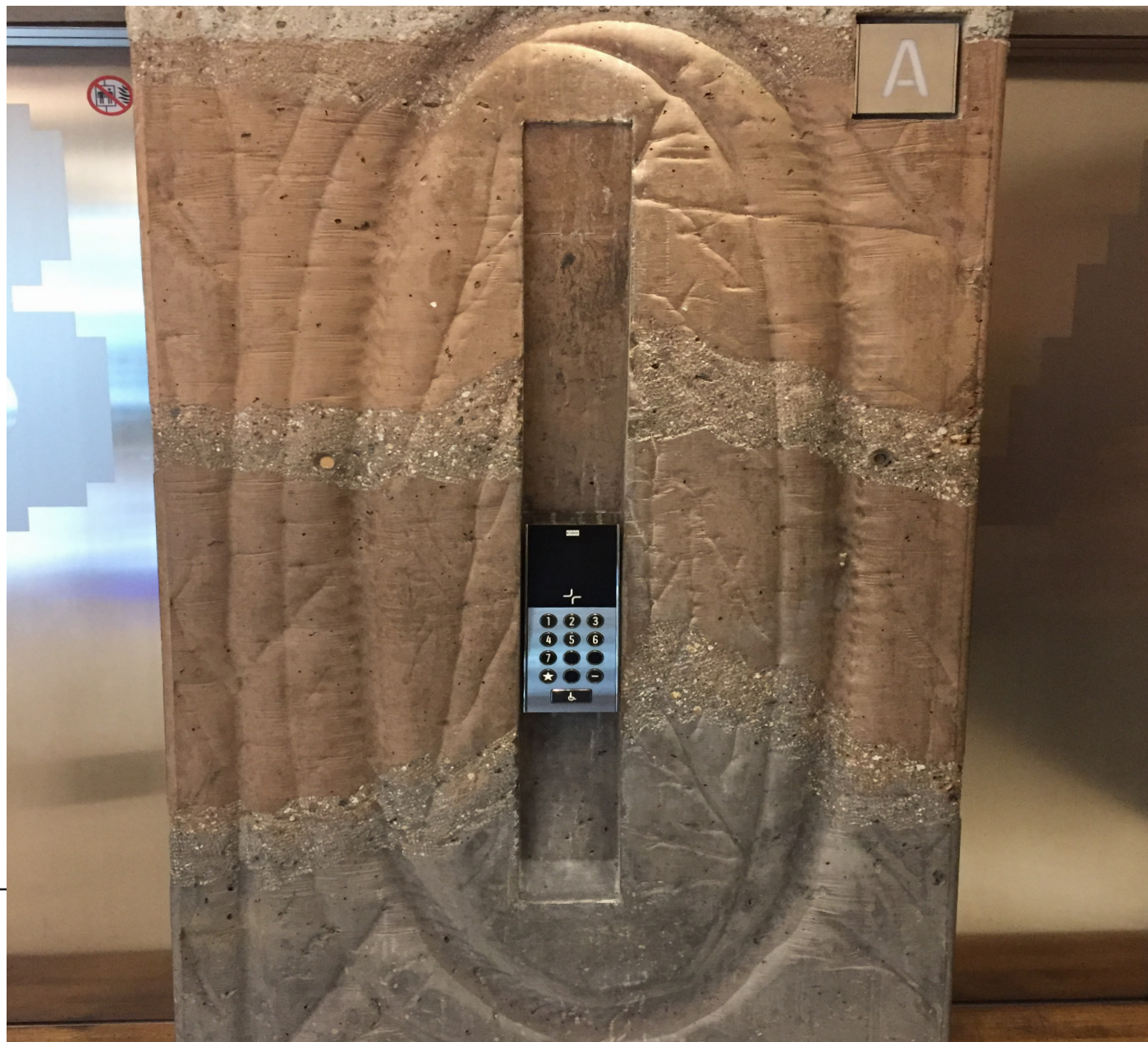
Detail různorodosti betonů a obtisk nuly.
