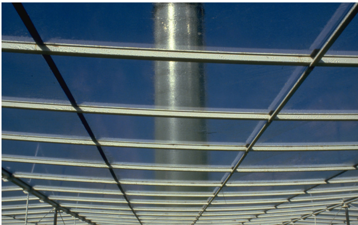
Vnitřní prostor kolektoru solární komínové elektrárny v Manzanares (jednoduché zasklení 4 mm)
