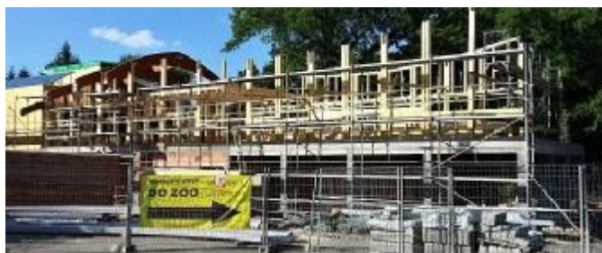
Správní a vstupní objekt ostravské ZOO.
